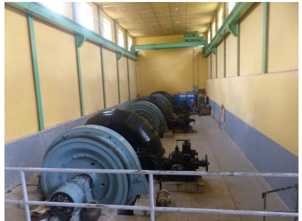
Blick auf die drei Turbinen „wo die Geschichte des Hospitals“ vor rund drei Jahrzehnten begann.
