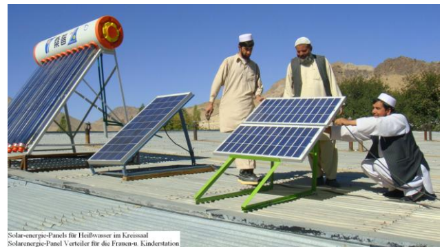
Solar-energie-Panels für Heißwasser im Kreissaal Solarenergie-Panels V. Verteiler für die Frauen- u. Kinderstation
